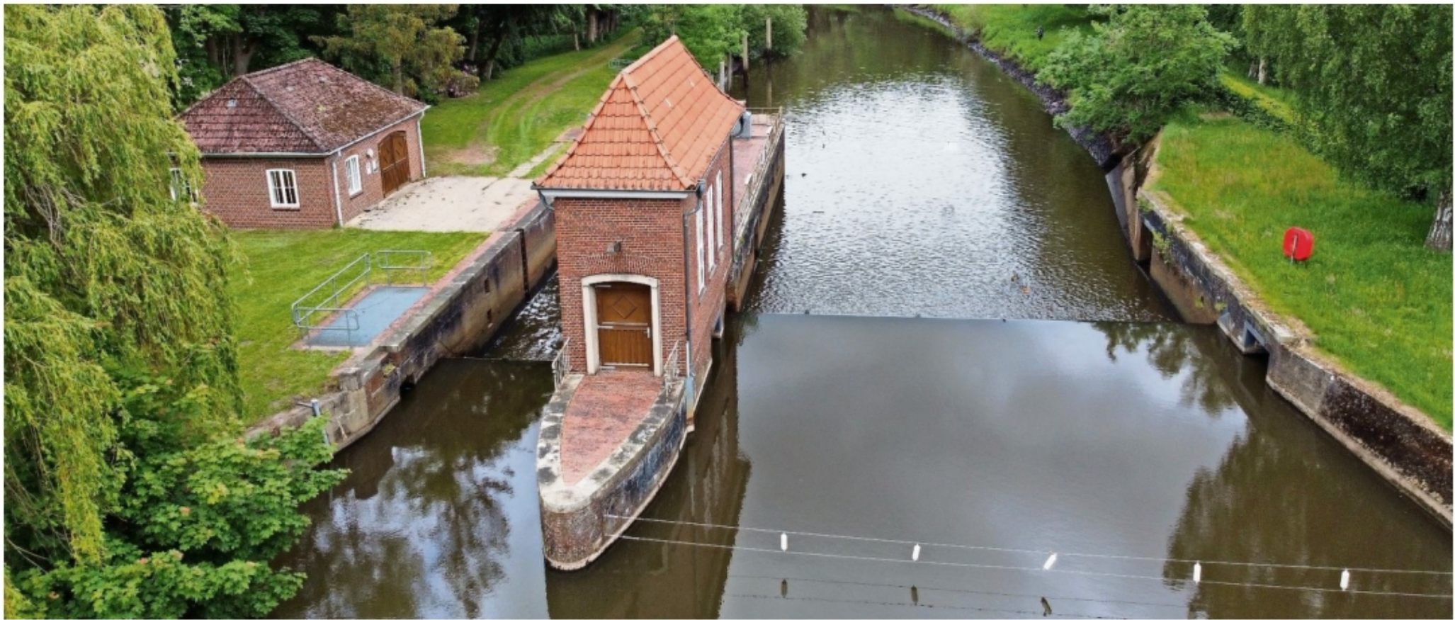
Das Bremervörder Oste-Wehr ist in seinem Bestand gefährdet. Das NLWKN will das Baudenkmal abreißen und bis 2027 durch eine etwa 80 Meter breite Sohlgleite ersetzen.
