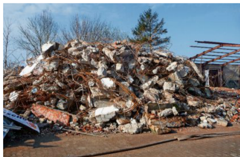
Nur ein großer Haufen Schutt ist von dem früheren Fahrschulgebäude übrig geblieben.
